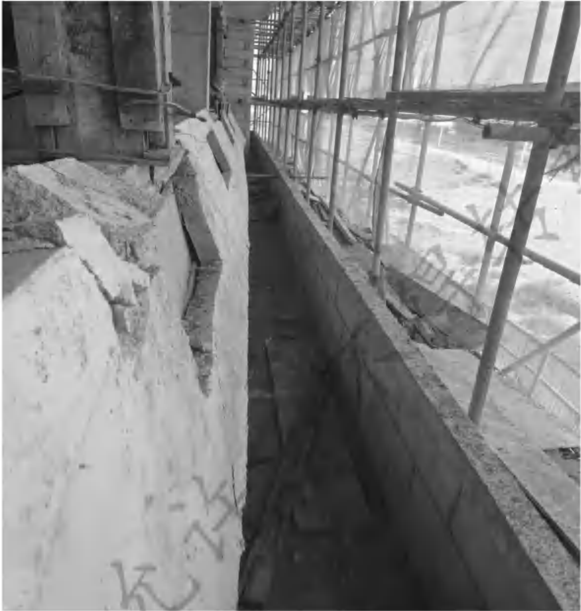
图 2 事故现场情况（位于综合楼二楼北侧）
