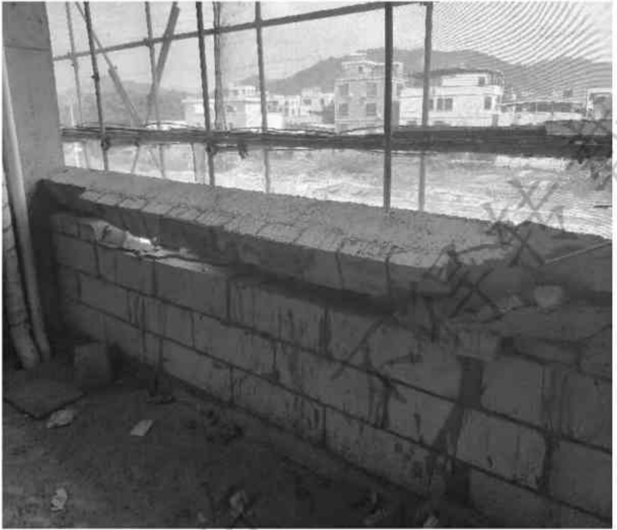
图 1 事故发生处（位于综合楼二楼北侧）
