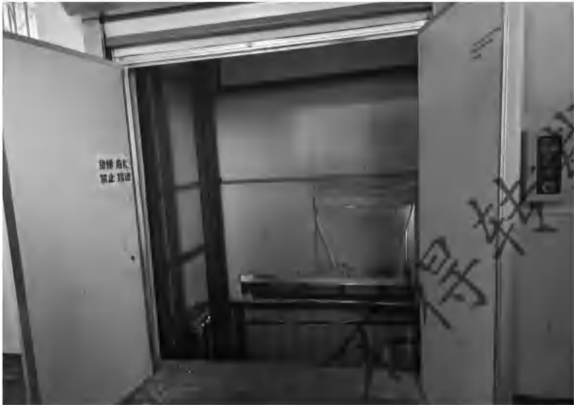
(图6 事故发生处——升降平台井道二楼)
