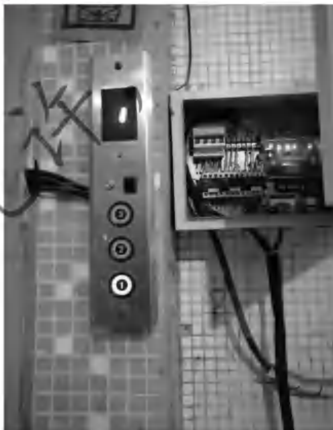
（图 3 一楼控制箱和上升楼层控制按钮）
