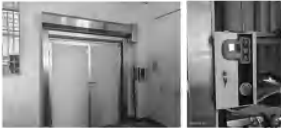
(图4 二楼、三楼上下升降控制按钮、急停按钮)
